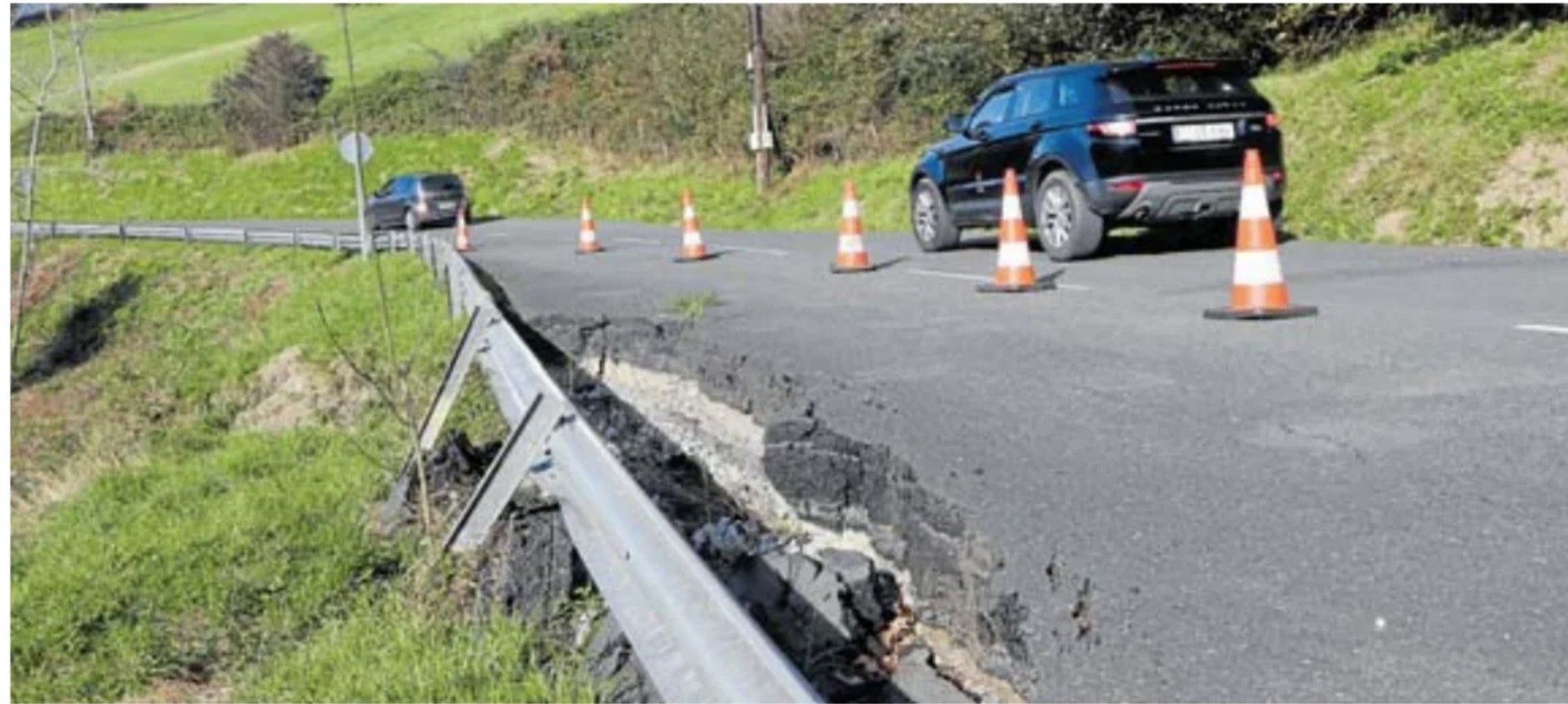
Uno de los tramos en mal estado de la vieja carretera que conecta el casco urbano de Elgoibar con el alto de Azkarate. J. LEON
