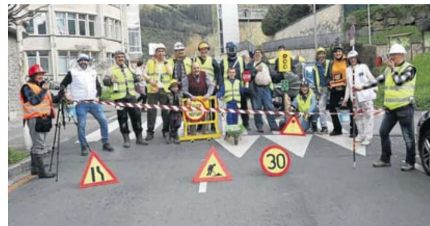
Por momentos, el acceso al centro urbano de Mendaro estuvo cerrado por obras.
